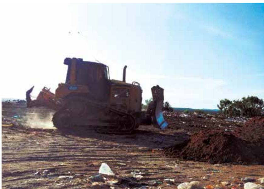
Foto 2. Operação do aterro em Aquiraz
